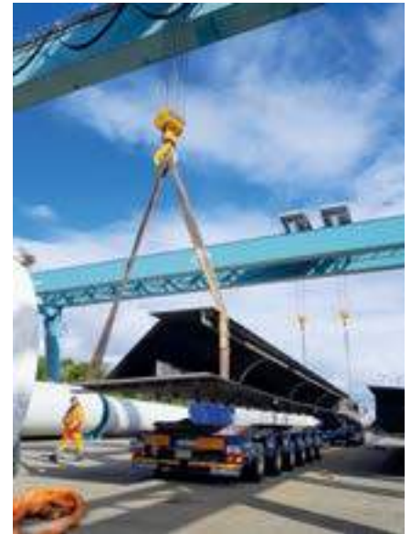
Eindrücke vom Transport großdimensionierter Bauteile der Sternbrücke in Hamburg-Altona. Foto: Torsten Emmerich (ARNOLD SCHWERLAST)
